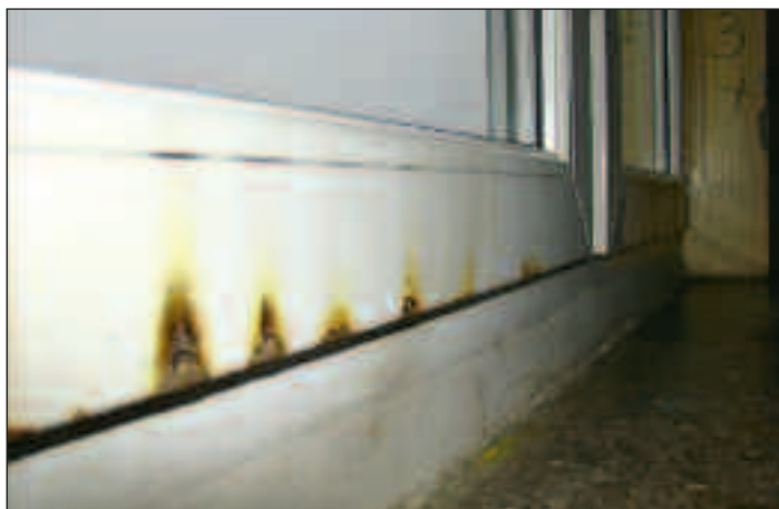
Osiedle XXX-lecia – próba podpalenia okna
