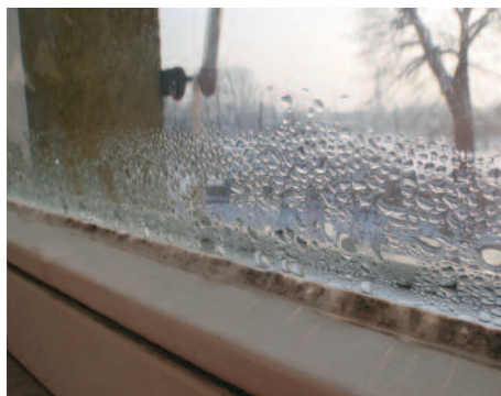
Pierwsza oznaka źle działającej wentylacji w domu – skraplająca się para wodna na szybach
