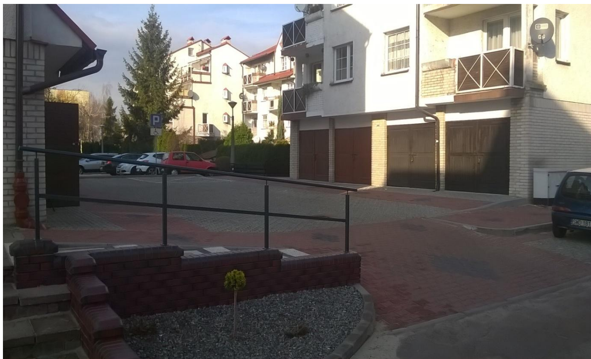
Wymiana nawierzchni dróg dojazdowych i miejsc postojowych przy ul. Dąbrówki 4 w Wodzisławiu Śląskim
